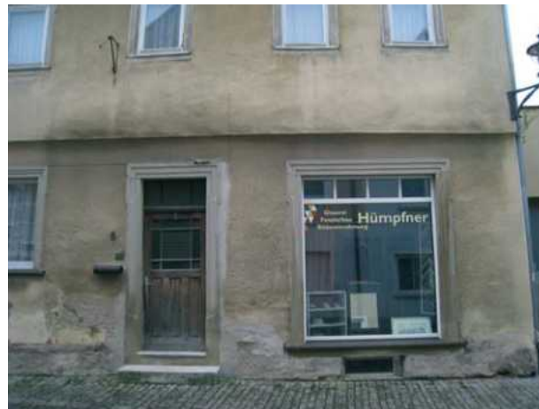
Schlechter Erhaltungszustand alter Bausubstanz in der Weiße-Turm-Straße
